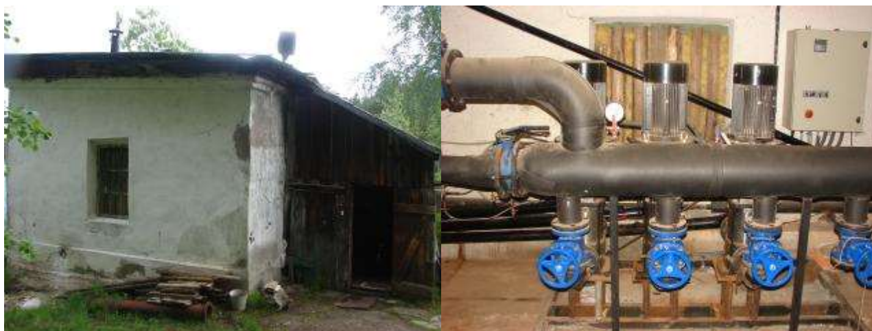
Рис. 2.2 Фото насосной станции п.г.т. Чупа, оз. Ивановское
